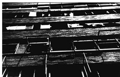
Ruinirane fasade objekta
