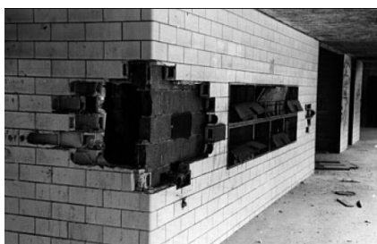
Vandalizovani poštanski sandučići
